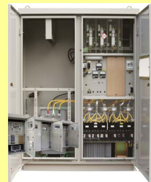
高圧受電設備
